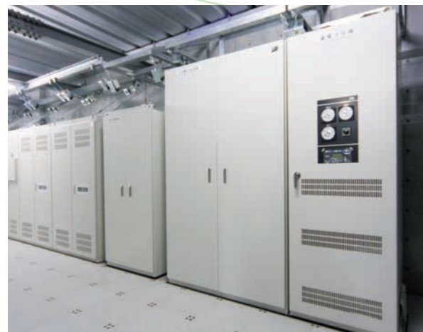
電気設備・周辺設備の完全二重化で安全対策
