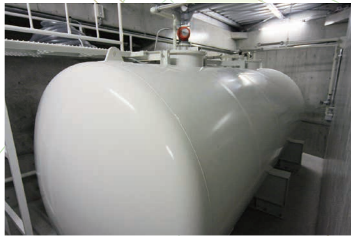
電源喪失に備えエネルギーを備蓄
